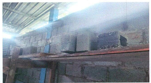
Foto 2: Pared aula cocina Módulo 2
